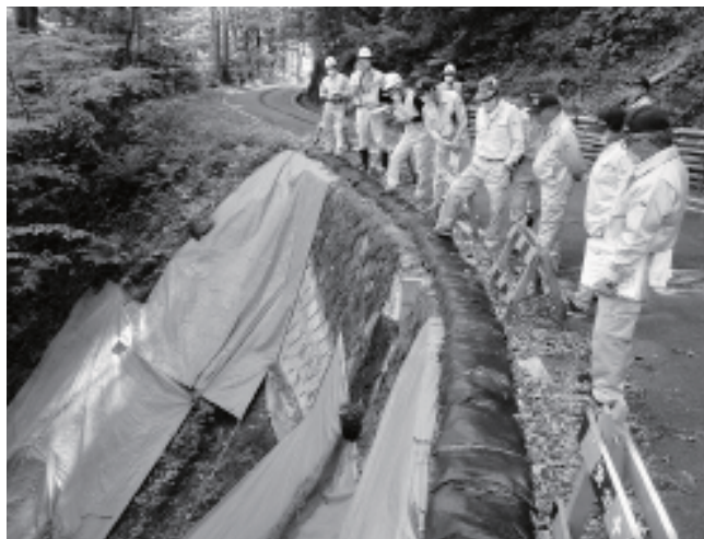
● 林道塩沢線 (崩落現場)
