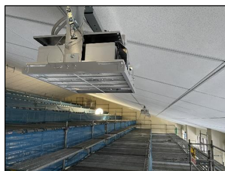
施設内照明のLED化（社会体育館）
